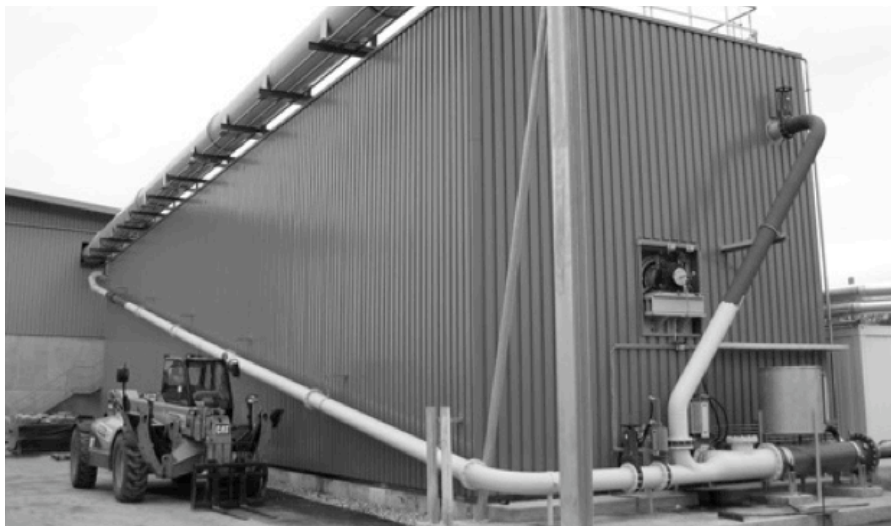
L'installation de Lavigny est la première installation romande de Kompongaz.
