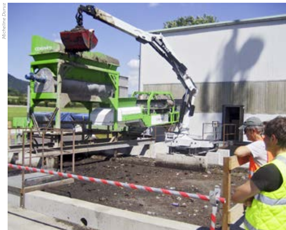
Dépôtage et unité d'alimentation.
