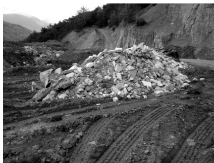
Séparer les déchets inertes de démolition des matériaux d'excavation propres, une des exigences du nouveau PCGD.
